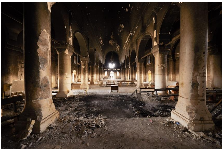
Irak: Eine durch den IS beschädigte Kirche
