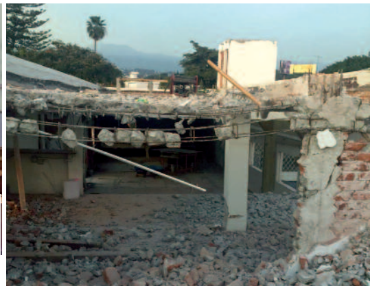
Nach dem Beben: Ein Teil musste ganz abgerissen werden.
